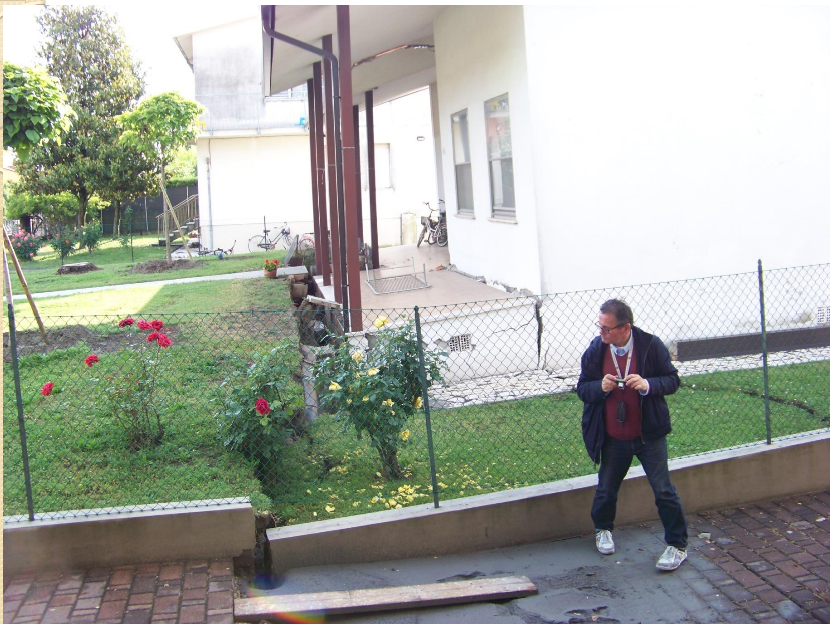
Frazione San Carlo; fenomeno di sprofondamento associato a fratturazione e liquefazione delle sabbie
