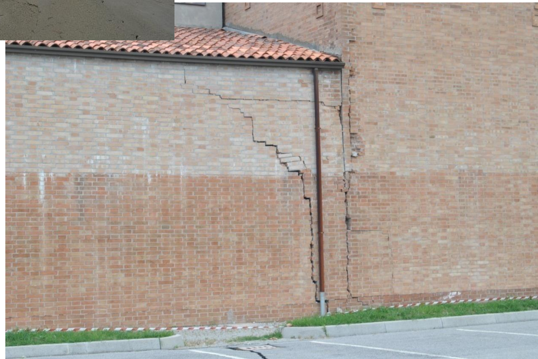
Cimitero di S. Agostino. Fratture nel muro perimetrale
